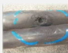
絶縁破壊により損傷したケーブル
